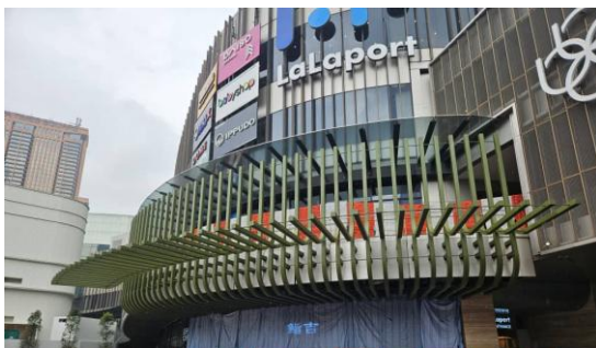
รูปที่ 21 ตัวอย่างโครงสร้างเหล็กของอาคาร
